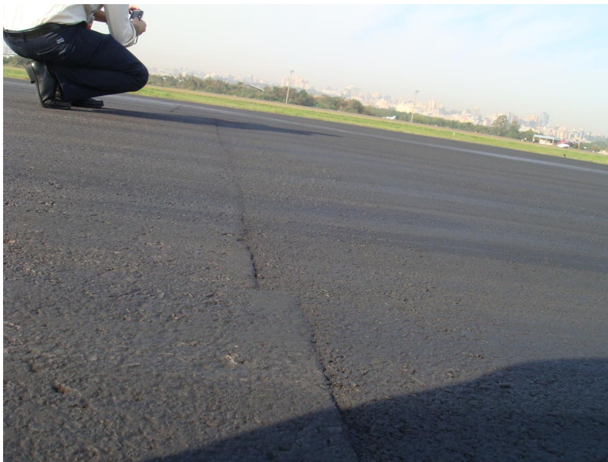
Desnível próximo à área central da pista.
